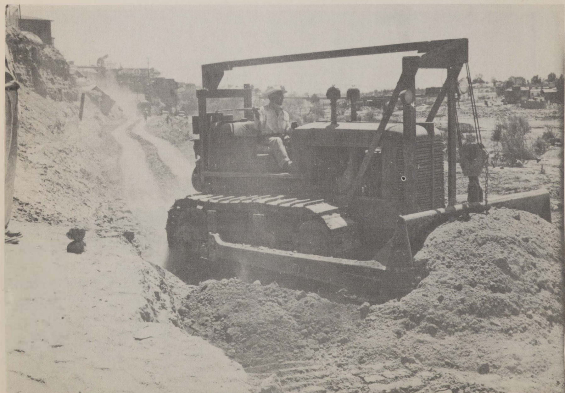
TERRACERIAS PARA GRAN COLECTOR AL SUR LINEA DIV. INTNAL. Y RIO NUEVO
